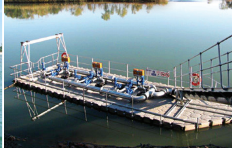
PLATAFORMAS PARA COLECTORES DE BOMBAS DE AGUA
