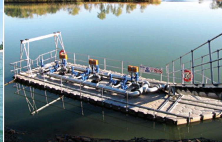
STATIONS DE POMPAGE
